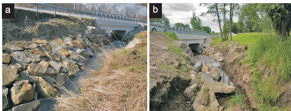
Ryc. 3. Stan obiektu po przebudowie: a) początkowe uszkodzenia ubezpieczenia brzegu, b) narzut kamienny blokujący przepływ w korycie
