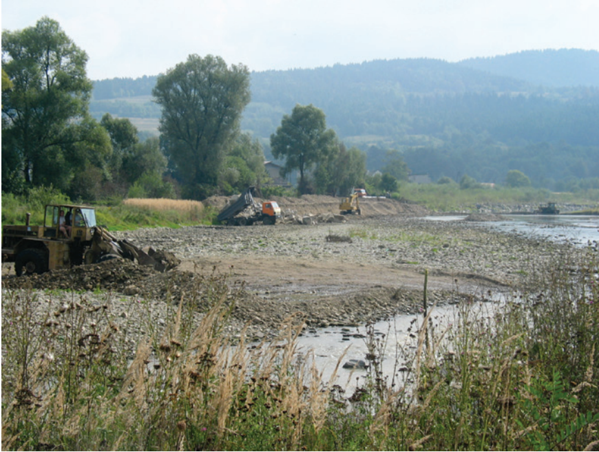
Fot. 2. Niekontrolowany pobór rumowiska, rzeka Skawa (fot. A. Radecki-Pawlik)
