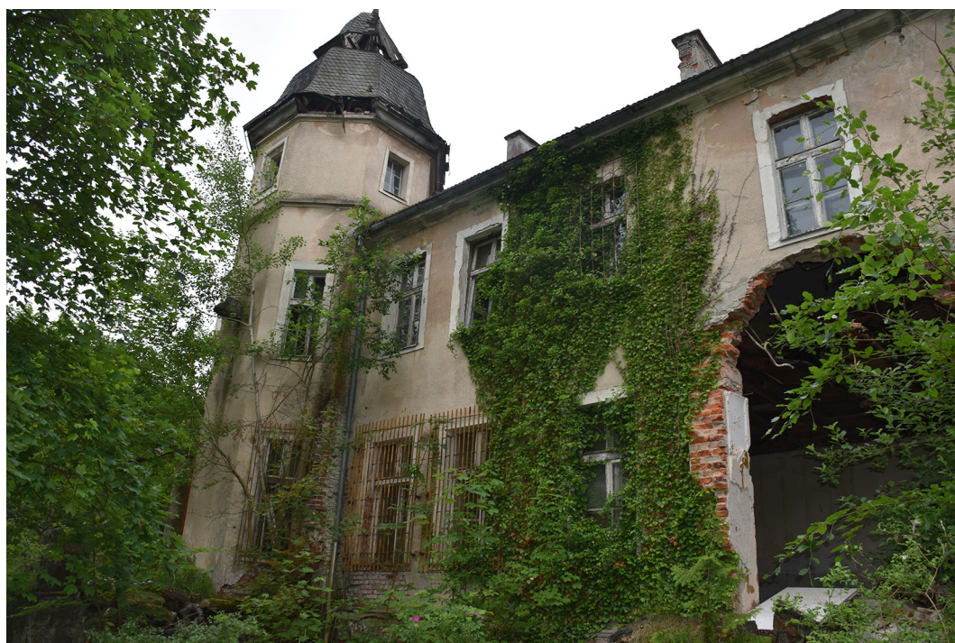
Fot. 2. Pałac w Iglicach, stan z 2023 roku. Po prawej stronie widoczny otwór po zawalonym wykuszu, widocznym na rycinie 4 (fot. M. Uruszczak)
